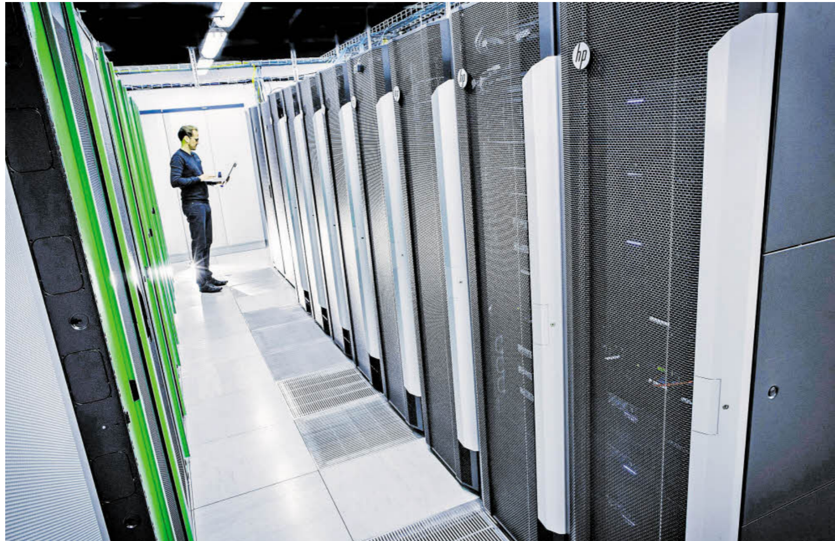
Blick in ein Rechenzentrum mit einer ganzen Galerie von Serverschränken. Sie brauchen Strom für den Betrieb und für die Kühlung.
